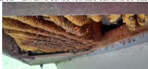
Figura 02 – Enxame sendo retirado caixaria de casa.
